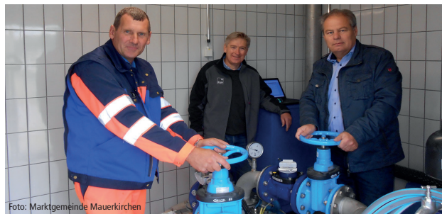
Foto: Marktgemeinde Mauerkirchen Wasserwart Johann Finsterer (v.l.), Peter Knechtelsdorfer von der Firma KUP und Bürgermeister Horst Gerner bei der Inbetriebnahme der Wasserversorgungsanlage
